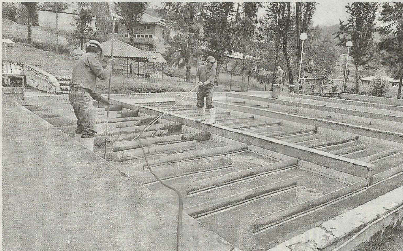
Uno de los convenios firmados por ETAPA y que está en esta discusión es la ampliación de la planta de Tixán. ← Archivo
